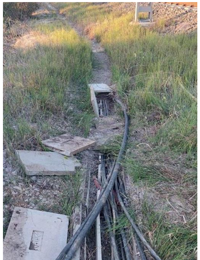
Una conducció de cable de coure/@rodalies
